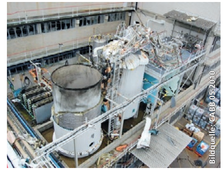
Kennen wir unsere Risiken? – Beispiel Abwassertank nach Explosion
